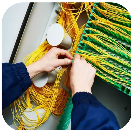
Réseau de fibre optique
